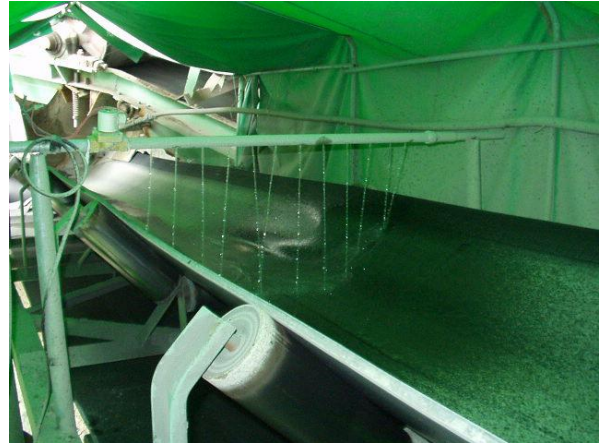
[그림 1] 골재 운반 컨베이어 벨트 살수시설
